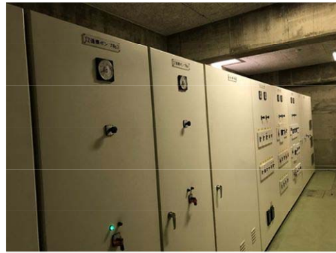
写真-38 電気室（動力・制御盤）
