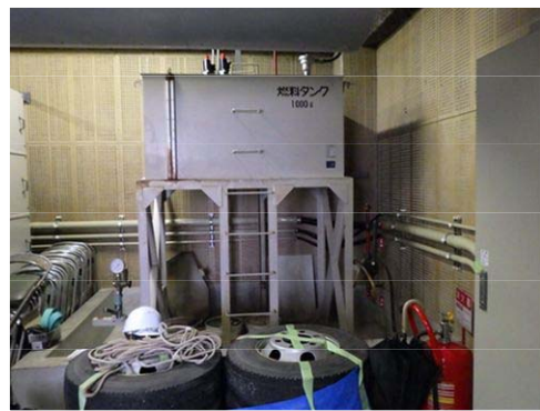
写真-40 燃料タンク（発電機用）
