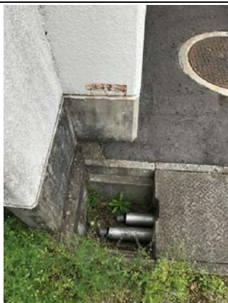
写真-補-3 重油配管 （端部処置）
