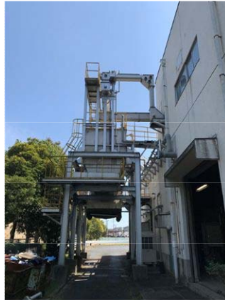
写真-16 脱水 汚泥ホッパー
