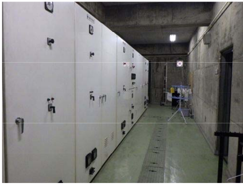
写真-37 電気室（受電・動力盤）
