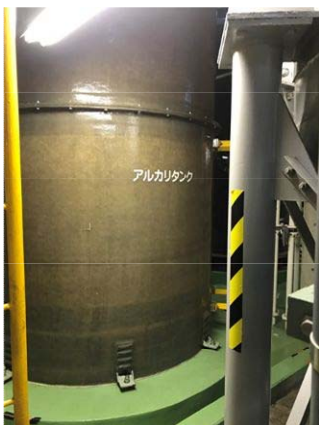
写真-27 アルカリタンク
