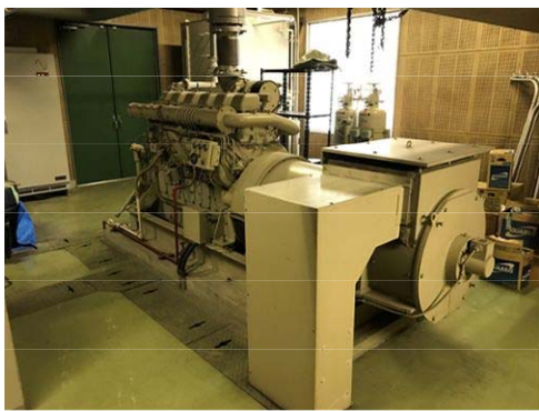
写真-39 自家発電機
