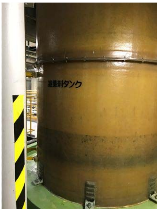
写真-25 凝集剤タンク
